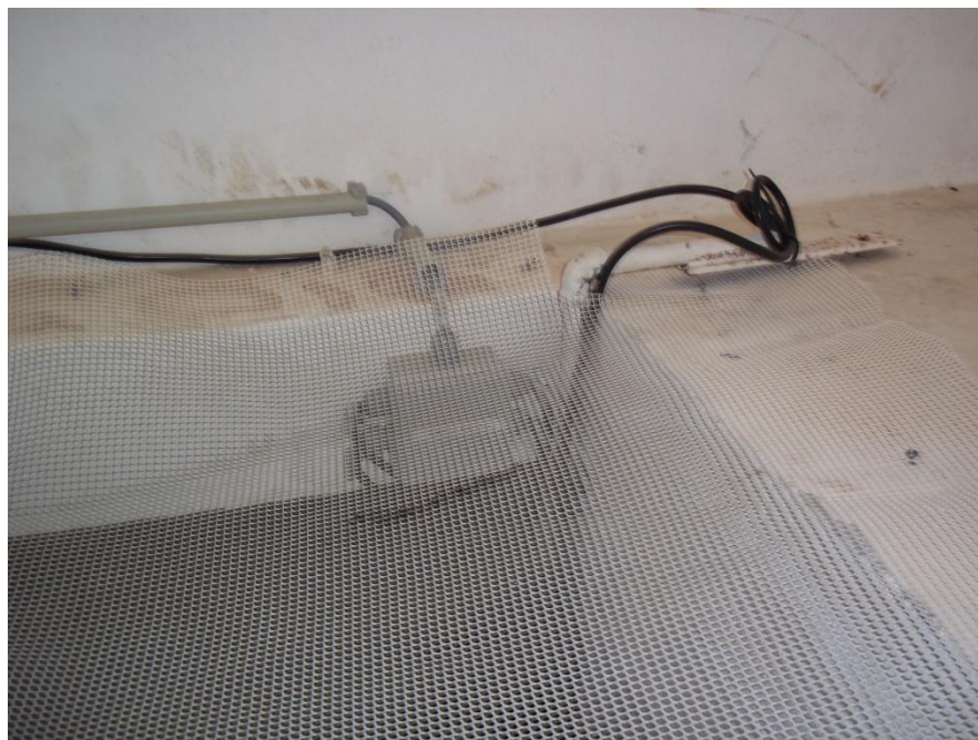
Proteção das entradas de Homem nos reservatórios
